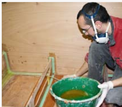
Après séchage et aspiration, badigeonnage de résine dans la zone à corniéragé.
