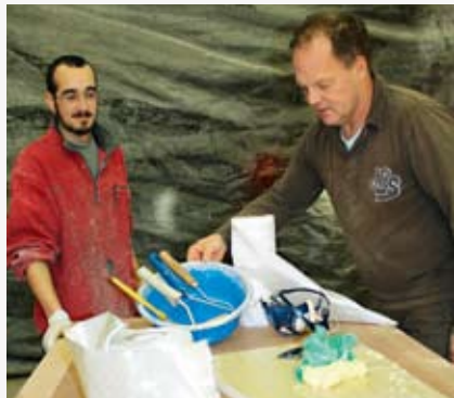
Tissu, résine, colle et rouleau : le nécessaire pour réaliser les joints congés.
